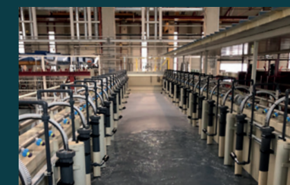
KTL i obróbka wstępna. 12 procesów zanurzeniowych do czyszczenia chemicznego i późniejszego powlekania KTL
