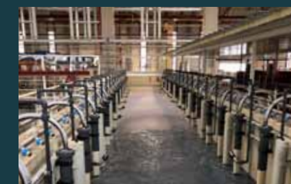
KTL i obróbka wstępna. 12 procesów zanurzeniowych do czyszczenia chemicznego i późniejszego powlekania KTL
